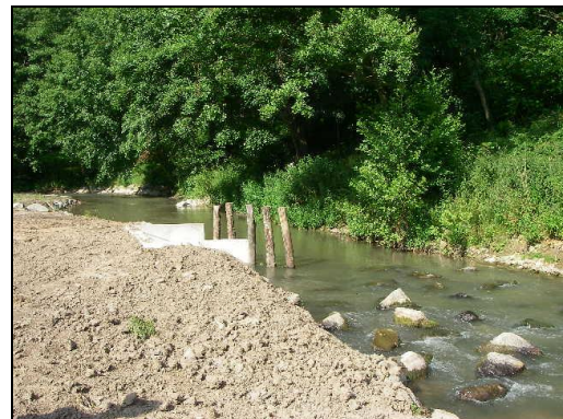
Prise d'eau installée en 2013
