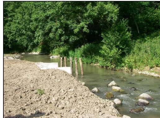
Prise d'eau installée en 2013
